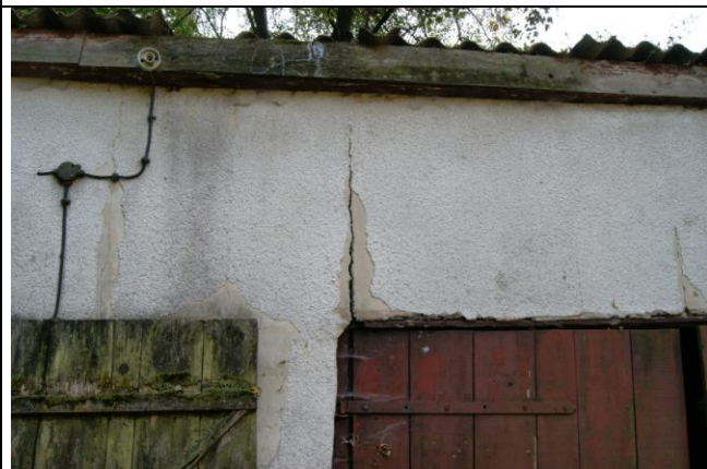
Uszkodzenia okładziny ściennej
