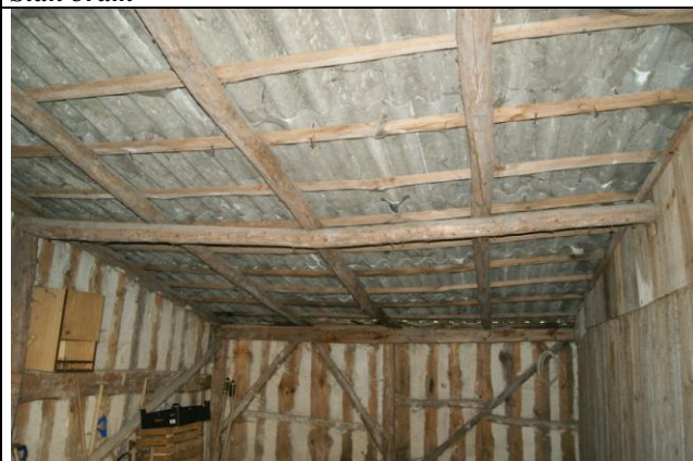
Ugięcia połaci dachowej
